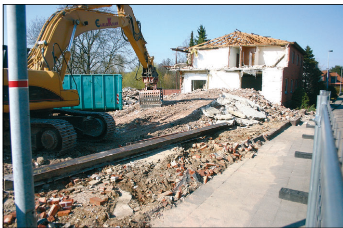
Endspurt: In der kommenden Woche soll der Abriss des „Hofmeister am See“ abgeschlossen sein.
